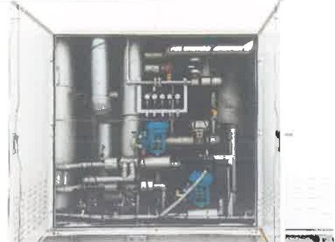
水素発電装置
